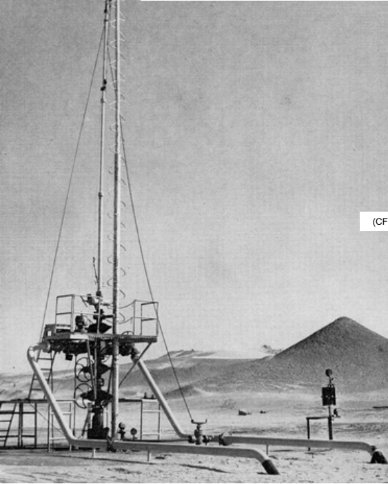
Puits d'injection de gaz sous pression, afin d'augmenter la production de pétrole
