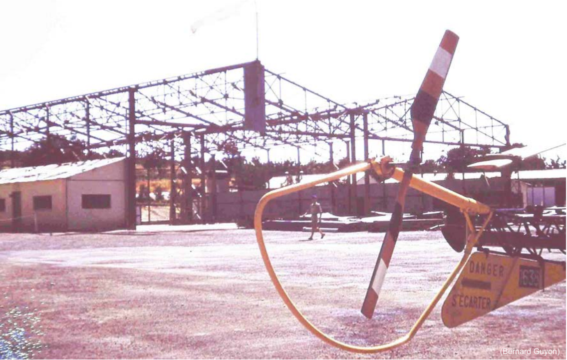
1 er PMAH 20 ème DI – Berrouaghia, démontage des hangars par le Génie parachutiste, été 1962
